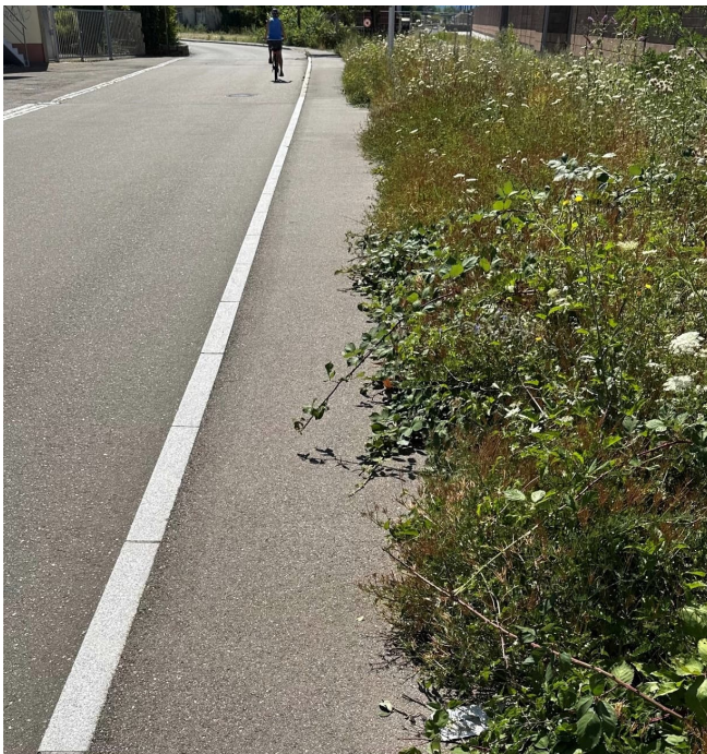
Abbildung 8: Eimeldinger Weg - Bewuchs auf Gehweg (Quelle: FWT)
